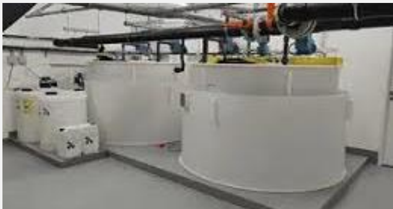
Local technique – Cuves de décroissance
